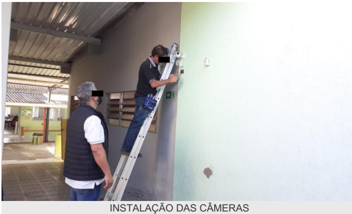
INSTALAÇÃO DAS CÂMERAS
